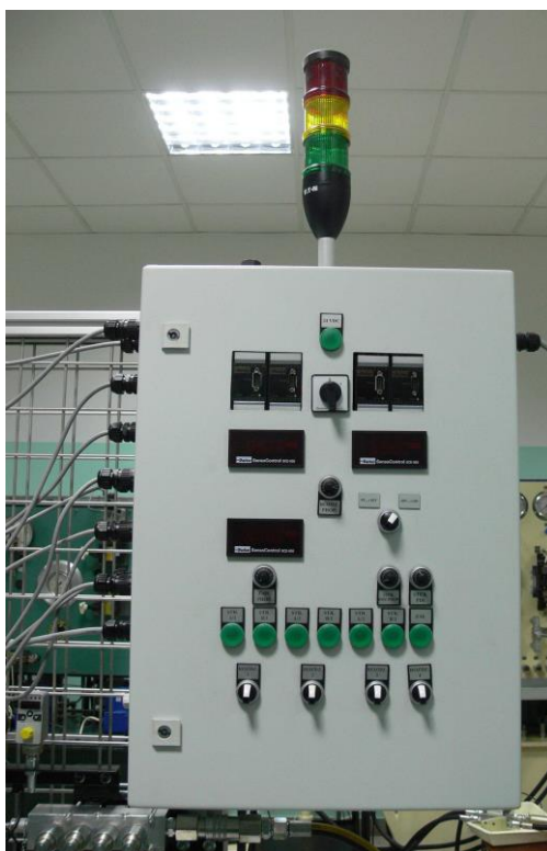
Fot. 2b. Widok szafy sterowniczej stanowiska nr 3 z kartami pomiarowo sterującymi
